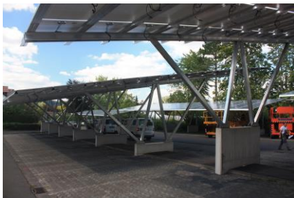
Landratsamt Marburg-Biedenkopf Im Lichtenholz, Marburg 166 kWp
